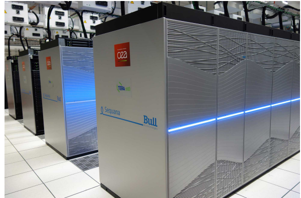
FIGURE 6.1 – Super-calculateur Tera1000 au CEA DAM à Bruyères-le-Châtel.
