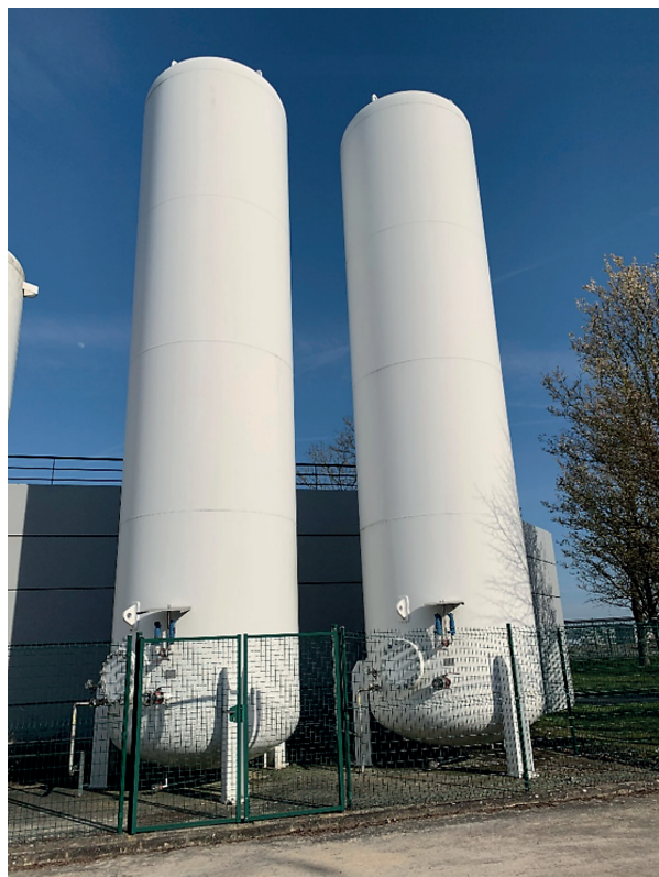
Fig. 235. Réservoirs d'hélium gazeux de 50 m 3 de l'installation NEUROSPIN.
