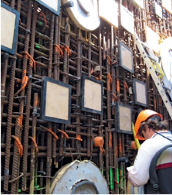
Fig. 241. Exemple de congestion d'une structure en béton armé.
