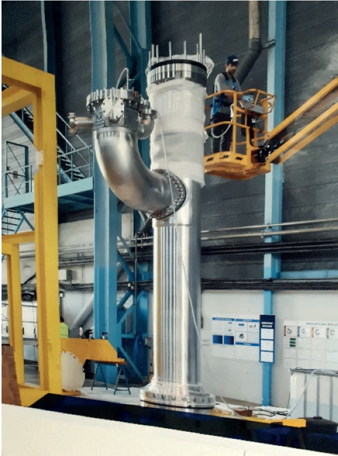
Fig. 232. Bloc pile du RJH, avant sa mise en place sur le circuit primaire du réacteur.
