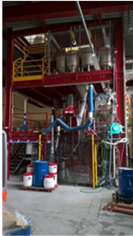
Figure 7 : Pilote PREMICE dans l'installation HERA
