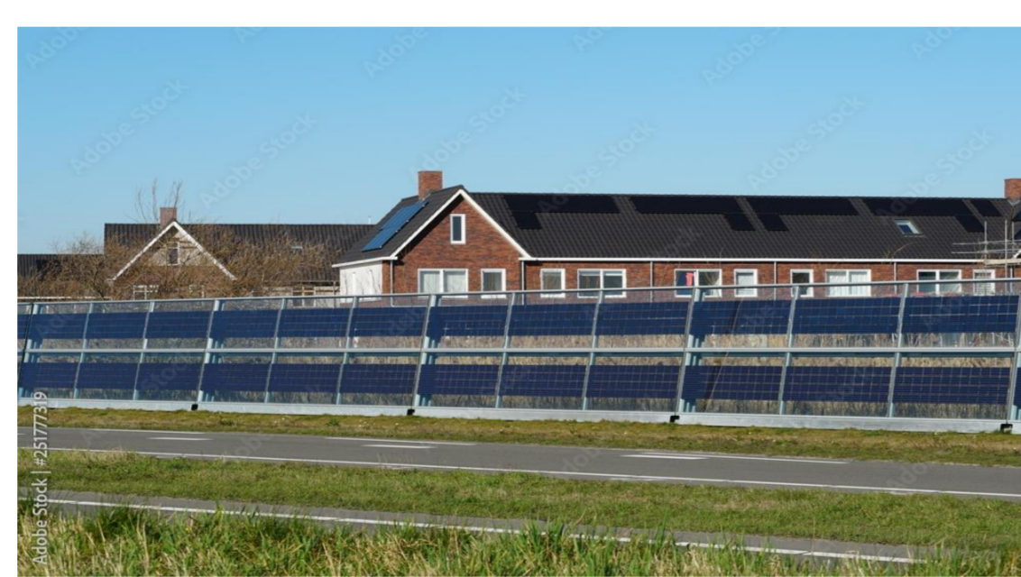
Acoustic Barrier Carretera N470 Pijnacker (Netherlands) Source: https://www.solarinnova.net/es/servicios/instalaciones/fotovoltaica/pvnb#descripcion%C3%B3n
