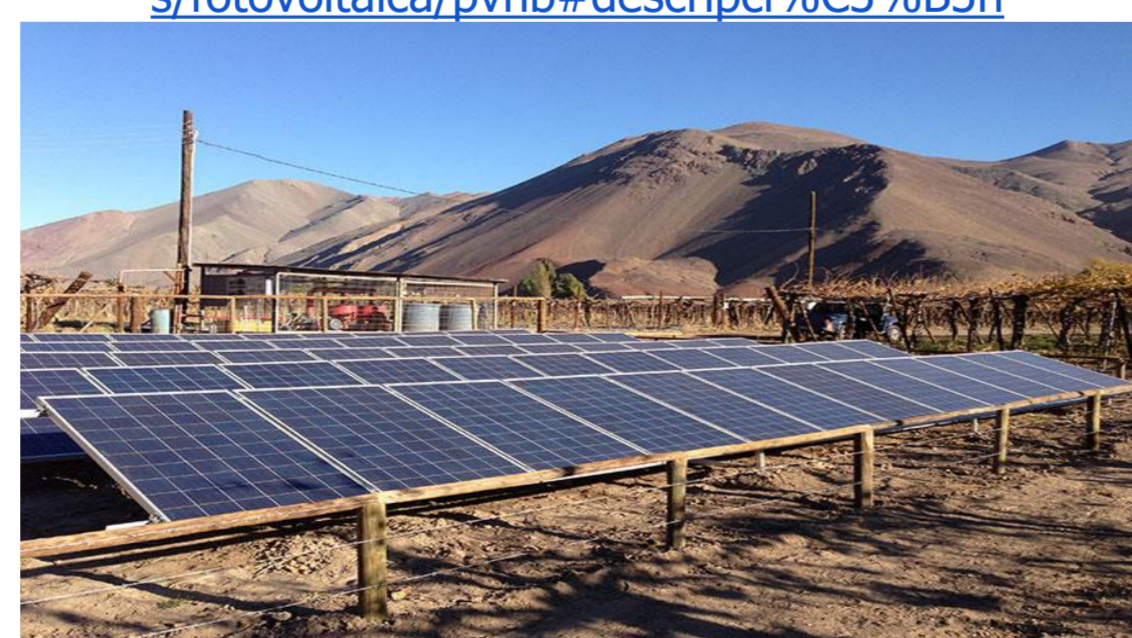
Irrigation Fundo Grossi e hijos (Chile) Source: https://tritec-intervento.cl/case_study/proyecto-solar-fundo-grossi-e-hijos/
