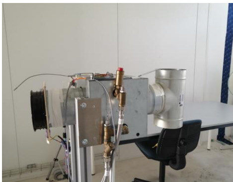
Fig. 3 : Echangeur de chaleur eau/air à l'intérieur de la cellule
