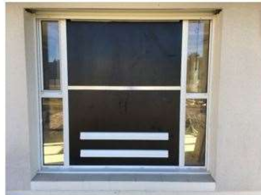
Aérateurs sur la façade Sud de la maison
