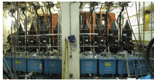
Figure 8 : Ensemble des Klystrons et de leurs interrupteurs associés
