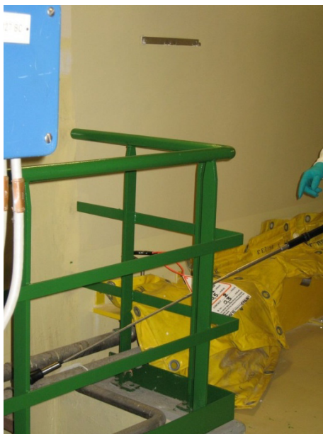
Figure 7 – Identification du point chaud dans le local PTR.
