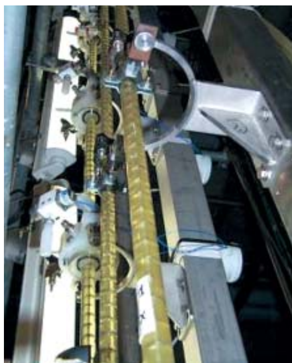
Fig. 132. Vue des colonnes pulsées, implantées dans la Chaîne Blindée Procédés de l'installation ATALANTE pour les essais de démonstration de la faisabilité technique de la séparation poussée réalisés en 2005.
