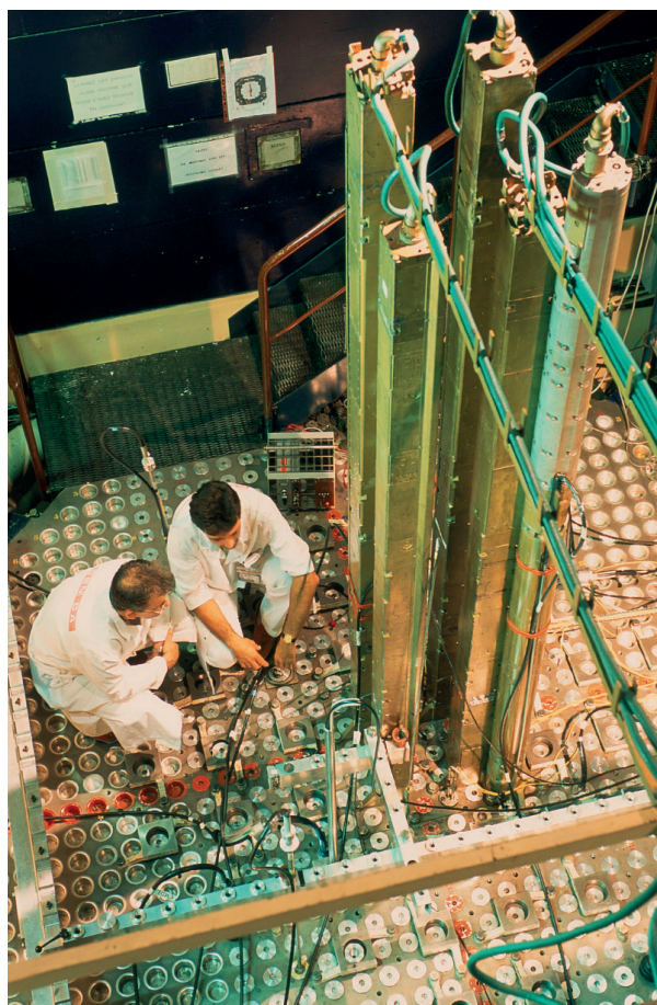
Fig. 53. Vue de la taque de suspension du cœur et des mécanismes des barres de sûreté de MASURCA.
