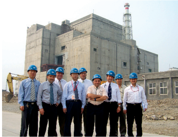
Fig. 199. Le réacteur CEFR en construction (2007), lors de la visite d'une délégation française.
