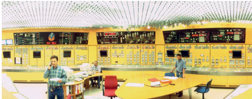
Fig.64. La salle de commande de SUPERPHÉNIX.
