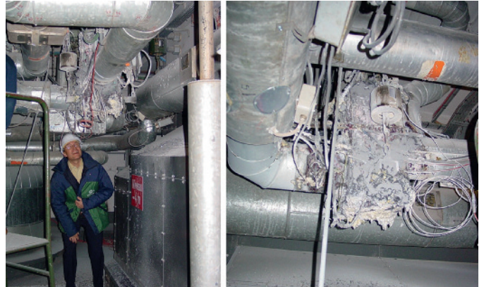
Fig. 69. Examen du circuit, après une fuite de sodium située sur le soufflet d'étanchéité d'une vanne de PHÉNIX.
