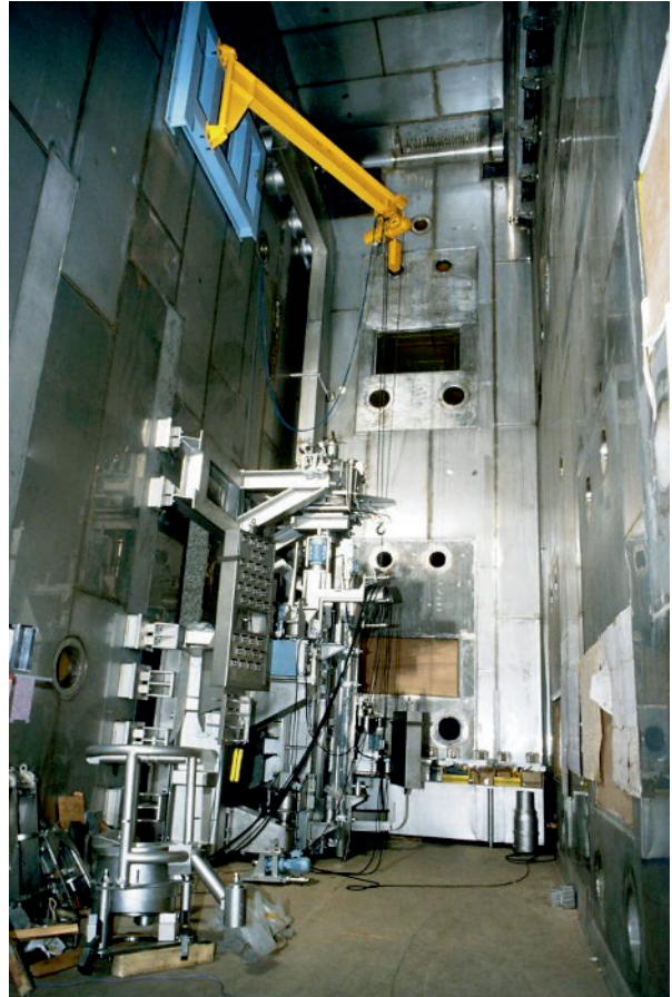
Fig. 178. Cellule de fusion des coques.
