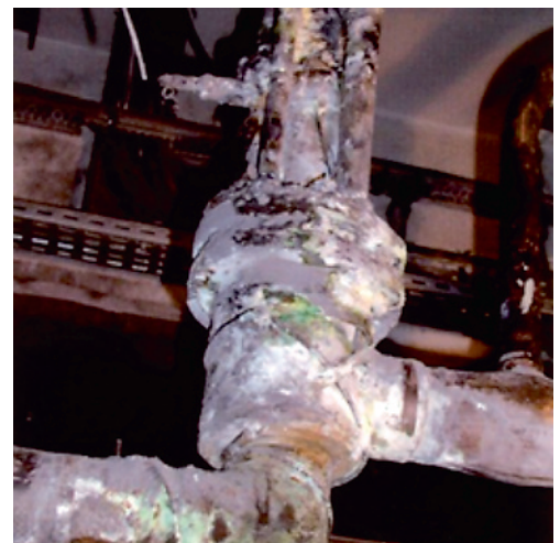
Fig. 94. Vanne décalorifugée après une fuite de sodium sur PHÉNIX.
